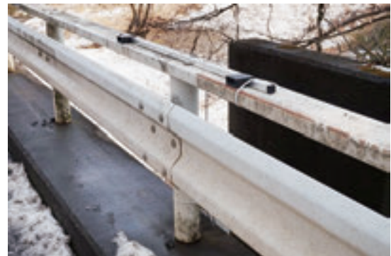
欄干に設置したセンサー
